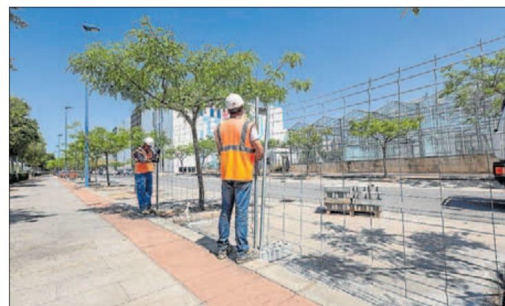
Obras del 2º módulo de la Facultad de Ciencias de la Salud. LEVANTE EMV
